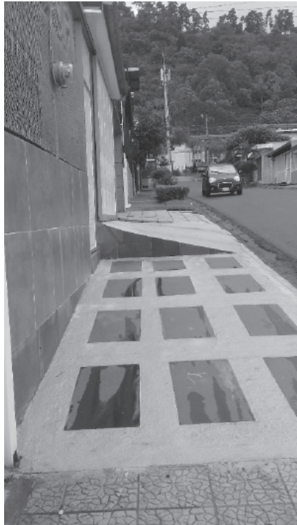
Figura 4. Acera construida con material cerámico que presenta una rampa para vehículo que interrumpe el paso peatonal. Desamparados.
