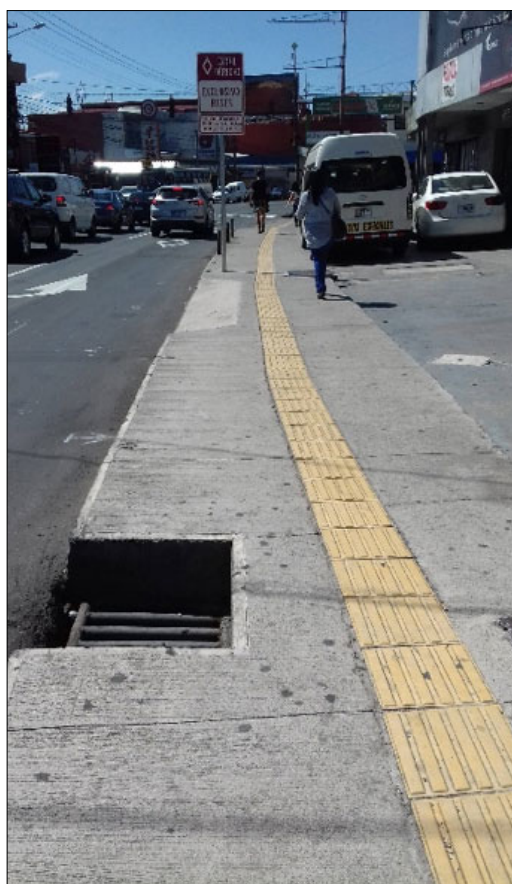
Imagen 5. Carretera Interamericana, San Pedro de Montes de Oca, San José. Se muestra una acera con baldosa táctil, en la que destaca un desnivel sobre la tapa de un drenaje, que genera una discontinuidad y peligro para el tránsito peatonal. Autora: Laura Paniagua Arguedas, 2018.
