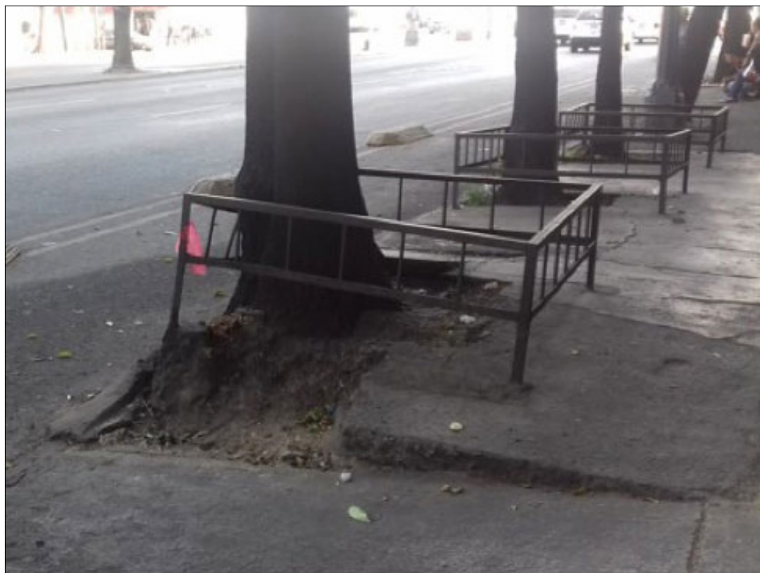
Imagen 7. Avenida Revolución, Ciudad de México. Se muestra una acera levantada por las raíces de un árbol, adicionalmente se percibe una estructura de metal que obstaculiza el paso, que rodea al árbol y le sirvió como protección. Autora: Laura Paniagua Arguedas, 2018.
