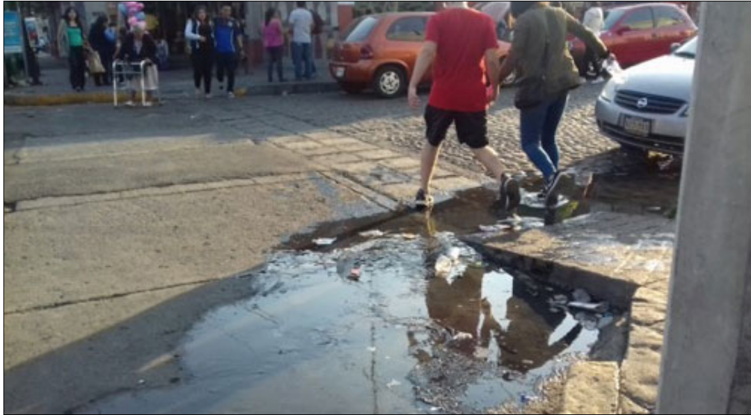
Imagen 8. Avenida Revolución, Ciudad de México. En la imagen hay una rampa para silla de ruedas entre la banqueta y la superficie de rodamiento de los vehículos automotores. Al finalizar la rampa en su parte más baja se encuentra gran cantidad de agua acumulada, que impide el uso adecuado de la misma. Autora: Laura Paniagua Arguedas, 2018.
